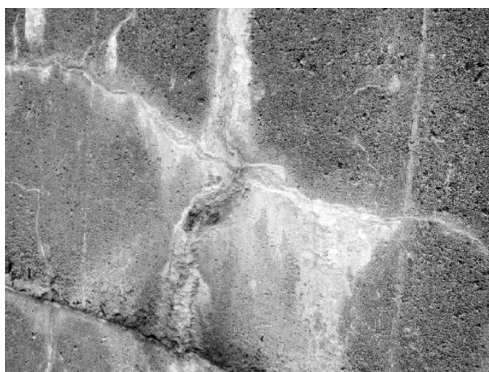
図3 ASRによるひび割れ
