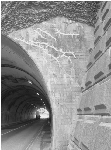
図2 ASRが生じたトンネルの例
