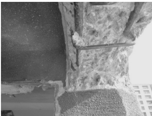
図5 中性化による鉄筋腐食
